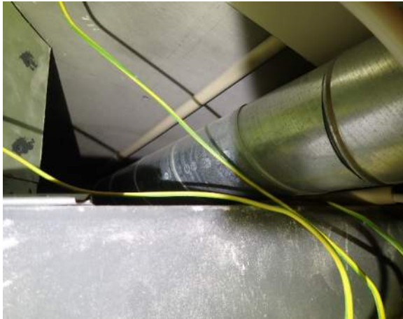
Figur 18. Inga misstänkta material har noterats på ventilationskanaler.
