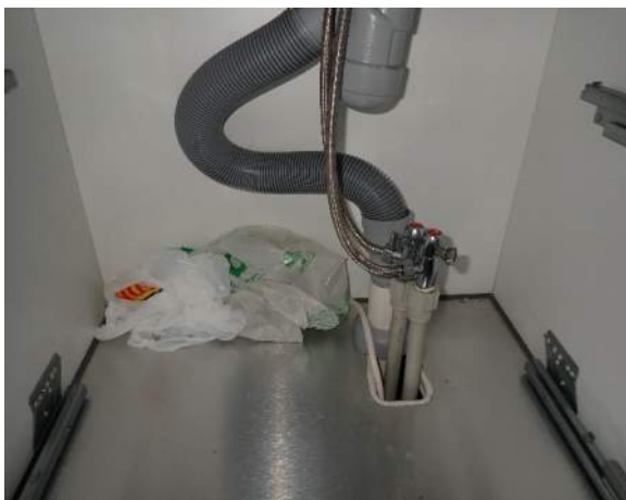
Figur 20. Spill- och tappvatten – ingen koppar har noterats.
